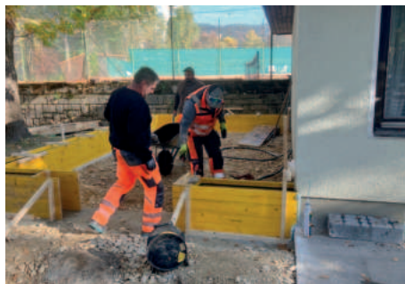
Robert Sobe mit seinem Team bei Schalungsarbeiten für den Zubau beim „Besenschwingerheim“
