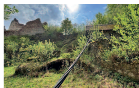
Die Stromzuleitung der Ruine Leonstein funktioniert wieder
