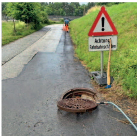
Schwierige Regenwasserbeseitigung am Kreggaberweg
